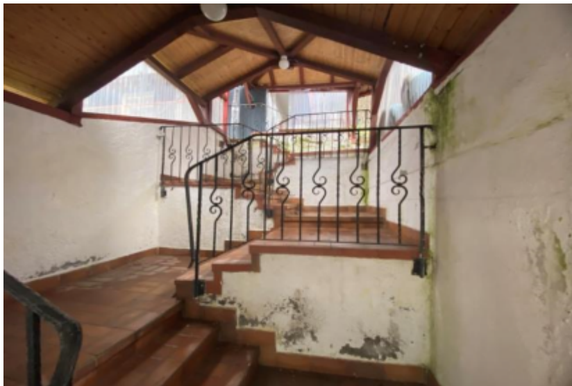
Abb. 4: Foto des SV; z.T. Eingangstreppeanlage mit Feuchteschäden
