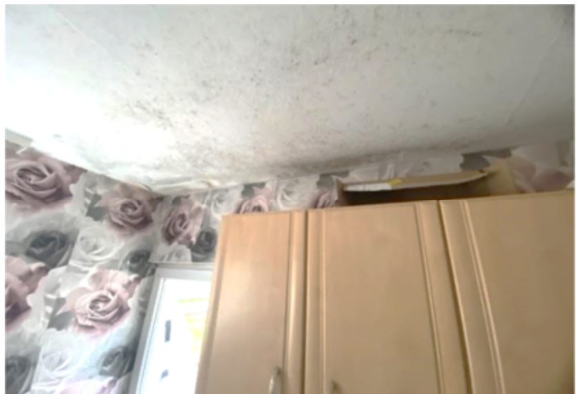
Abb. 11: Foto des SV; z.T. Feuchteschäden/Schimmelbildung Wohnung OG
