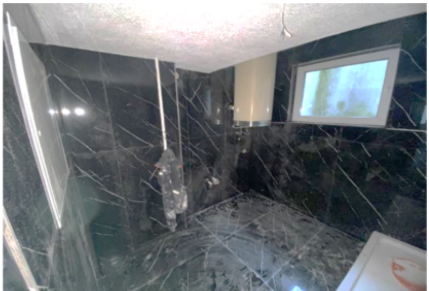
Abb. 9: Foto des SV; z.T. Fertigstellungsbedarf; Wohnung UG (Bad)
