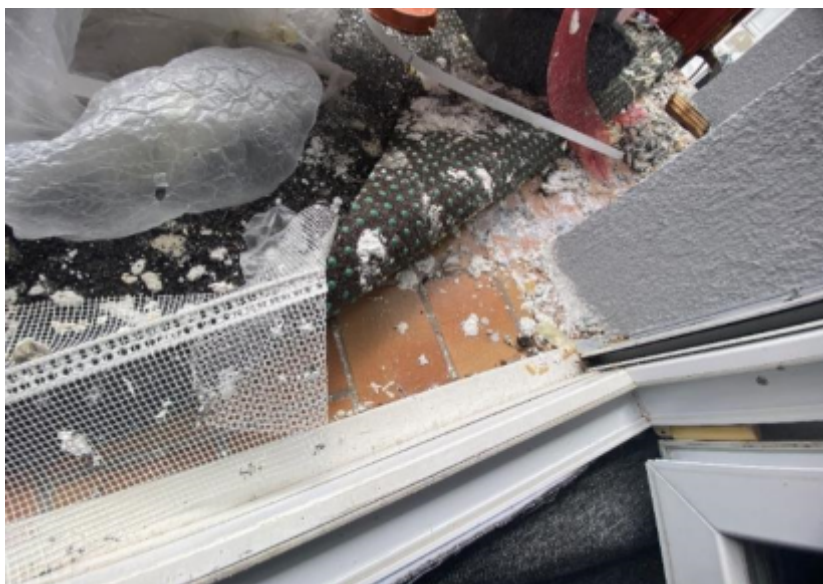
Abb. 6: Foto des SV; z.T. unsachgemäße Bauteilanschlüsse
