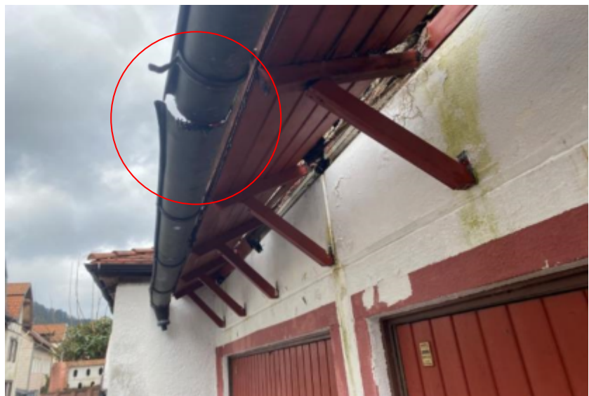
Abb. 3: Foto des SV; schadhafte Überdachung
