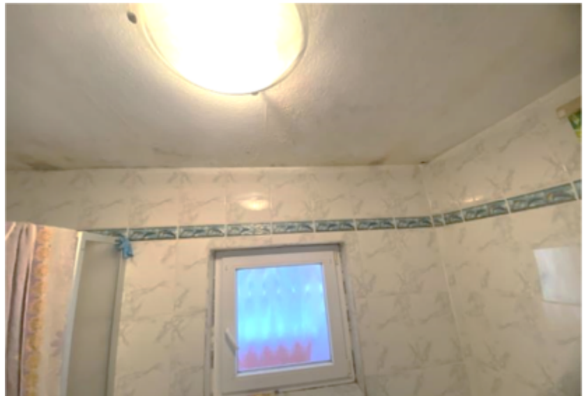
Abb. 10: Foto des SV; z.T. Feuchteschäden/Schimmelbildung Wohnung OG
