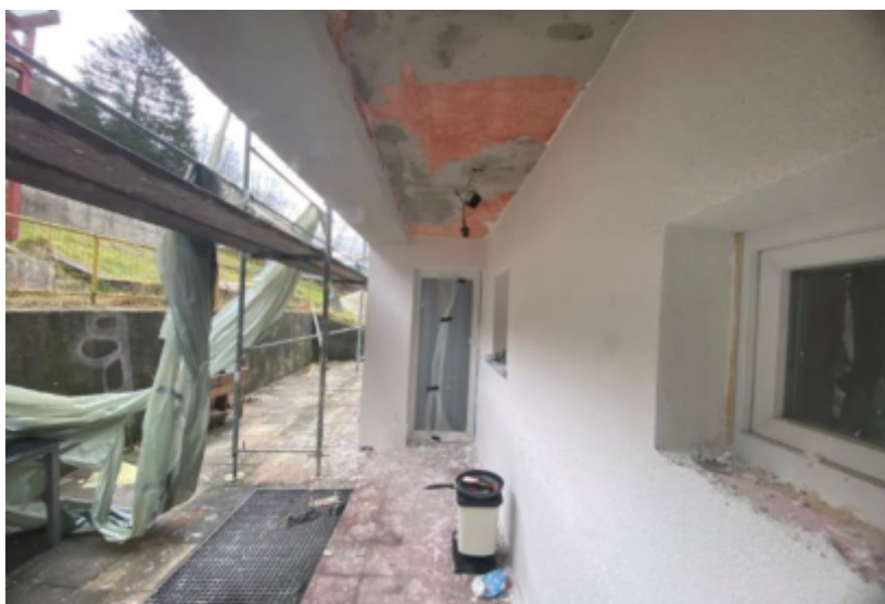
Abb. 5: Foto des SV; z.T. fehlende Fensterbänke (EG), Verschmutzungen
